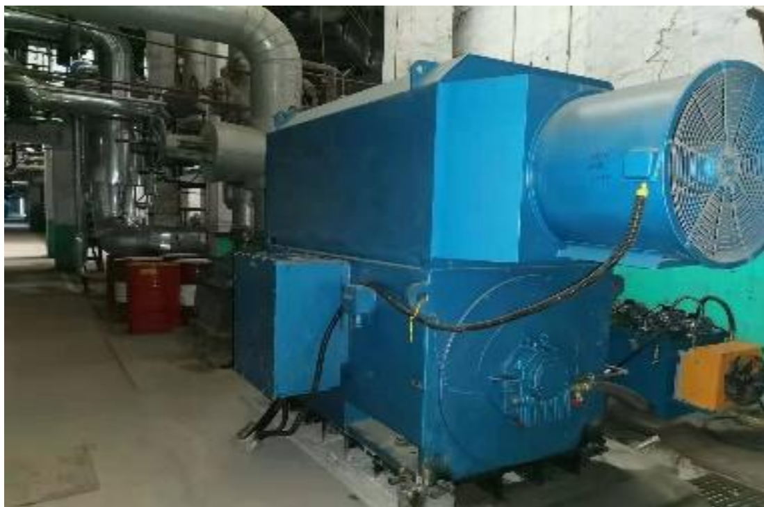
图3 负载给水泵外观
