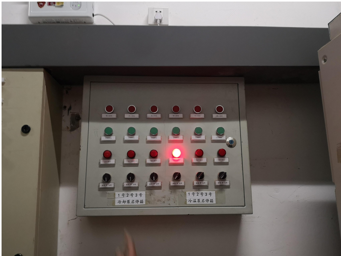
图 1 改造前控制柜
