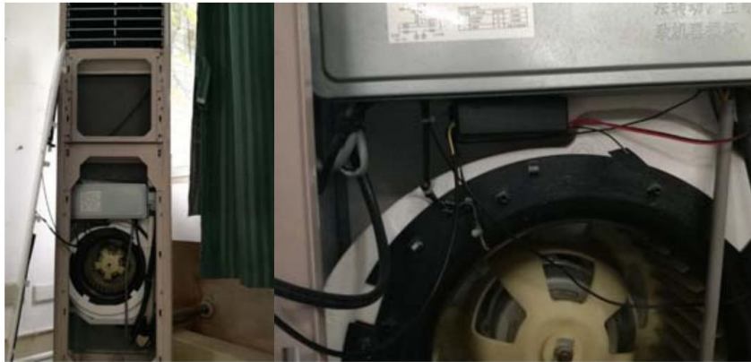
图 2 改造前分体空调现场核查照片
