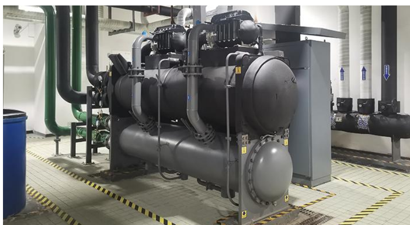
图 6 改造后机房现场图
